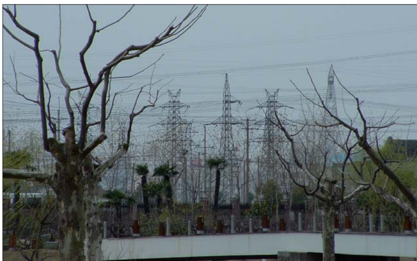
Bild 6. Umspannwerk bei Shanghai
